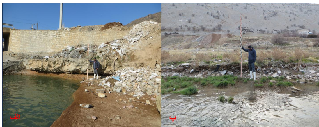
شکل (۲): الف) برش بستر رودخانه در پایه پل، ب) برش و فرسایش حاشیه رودخانه در بخش اول
