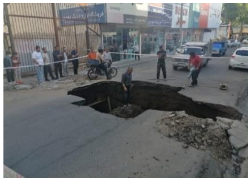
شکل (۴): فرونشست زمین در تاریخ ۱۴۰۲/۰۲/۰۶ در ساعت ۱۴ بعد از ظهر در منطقه شهری مهرشهر و گلشهر
