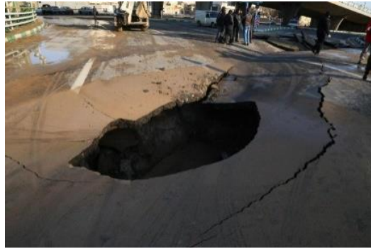
شکل (۲): فرونشست زمین در تاریخ ۱۴۰۰/۰۹/۱۲ در ساعت ۲ بامداد در منطقه شهری و تجاری شهرستان کرج - رجایی شهر
