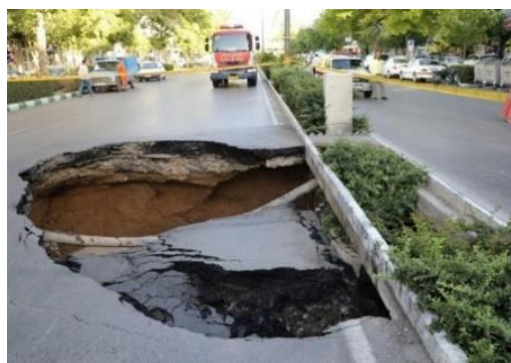
شکل (۵): فرونشست زمین در تاریخ ۱۴۰۲/۰۶/۱۸ در ساعت ۸ صب در منطقه شهری مهرشهر خیابان چهارباندی
