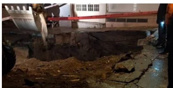
شکل (۳): فرونشست زمین در تاریخ ۱۴۰۱/۰۳/۱۴ در ساعت ۱۸ غروب در منطقه شهری و مرکزی کرج - میدان سپاه
