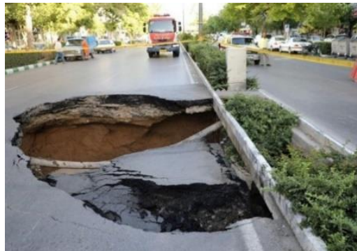
شکل (۵): فرونشست زمین در تاریخ ۱۴۰۲/۰۶/۱۸ در ساعت ۸ صبح در منطقه شهری مهرشهر خیابان چهارباندی
