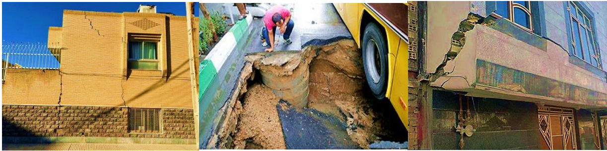
شکل (۱۷): تصویر سمت چپ ترک ساختمان در محدوده حصار کرج - تصویر میانی فرونشست در خیابان جمهوری به سمت میدان سپاه ضلع شمال شرقی باغ فاتح - تصویر سمت راست ترک بر روی ساختمان نوساز در حصارک پایین کرج
