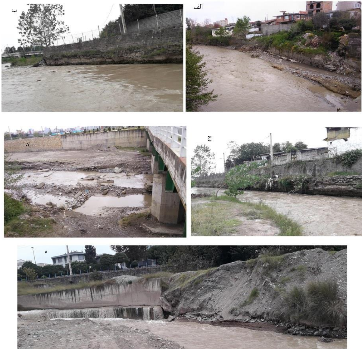
شکل (۸): تصاویری از مخاطرات ژئومورفولوژیکی رودخانه هراز، الف) زیربری و تخریب دیوار حفاظتی، ب) زیربری دیوار حفاظتی در اثر فرسایش بستر رود، ج) فرسایش کناره مقعر و زیربری، د) فرسایش بستر رود در پایه پل، ه) فرسایش و فرسایش کناره رود
